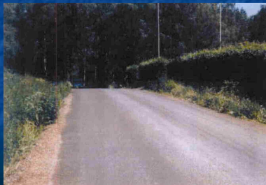
Väg med flygaska ca 7 år efter renovering Askan höll 5 % cement samt även fiberslam
